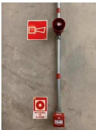
Figura 12: Alarme de incêndio
