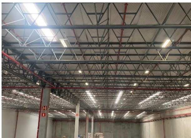
Figura 9: Sprincker - Área de Armazenagem
