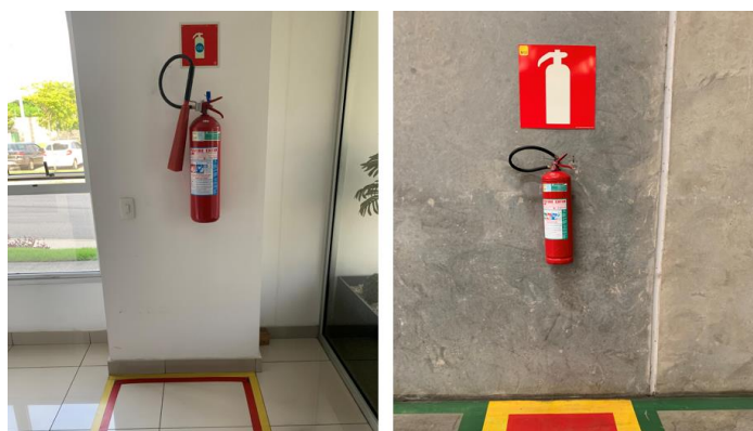
Figura 4: Extintores de portáteis
